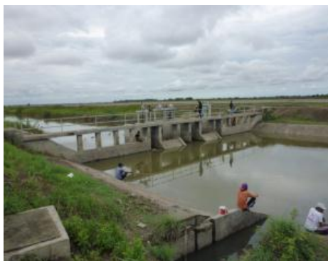
Gambar 7. Pintu air di rawa Sragi (Lampung) IP 200
